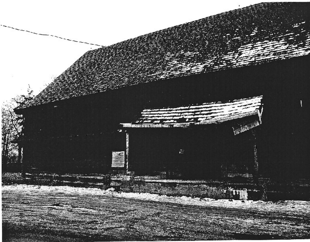
Fot. 1 Widok od strony północnej, widoczne załamanie dachu nad rampą spowodowane demontażem słupa i płatwi
