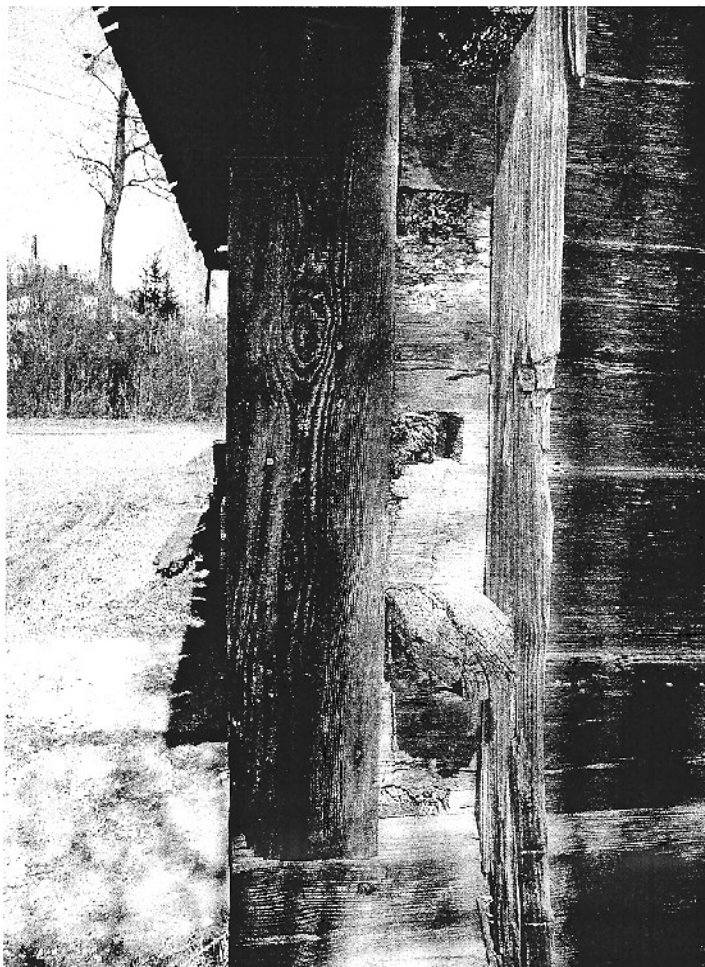
Fot. 4 Zniszczone ostatki w narożniku południowo- wschodnim
