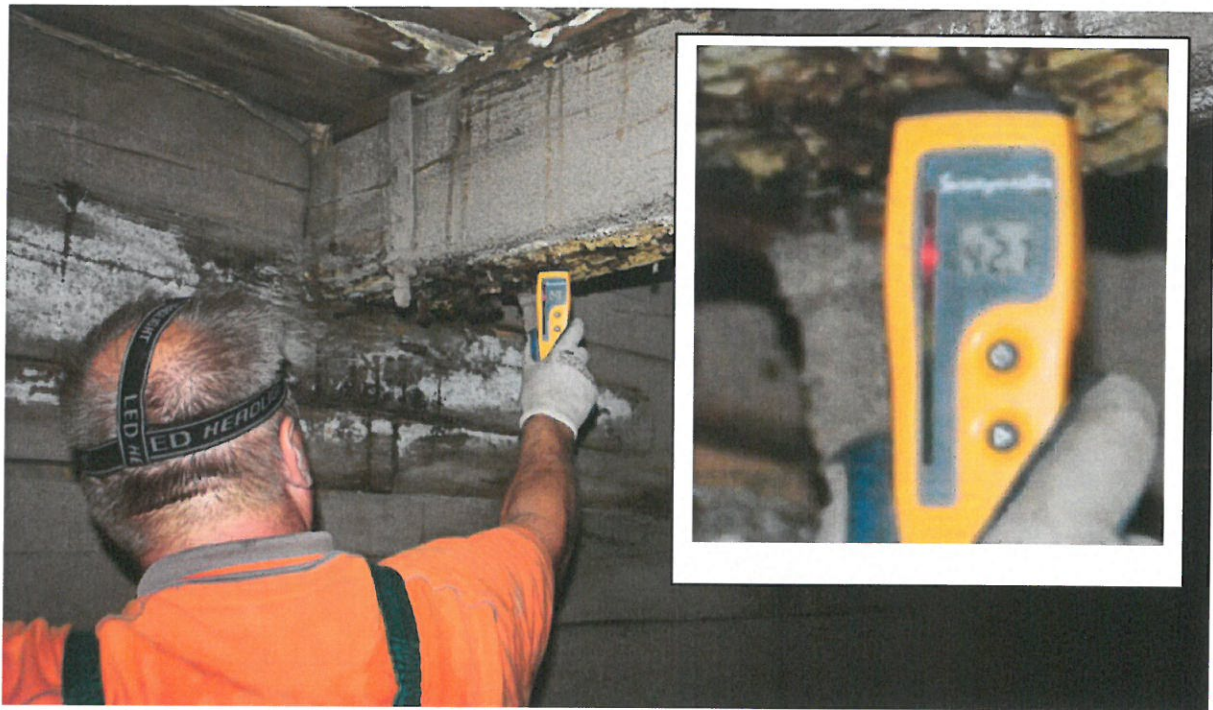
Zdjęcie górne - zawilgocenie na poziomie 40%
