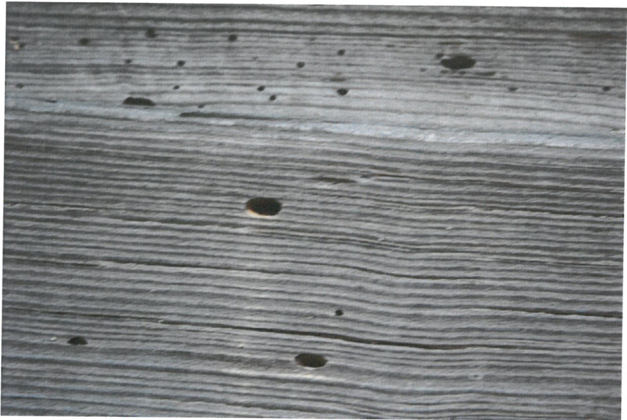
Otwory wykonane przez szkodniki drewna – Kółatek i Spuszczel
