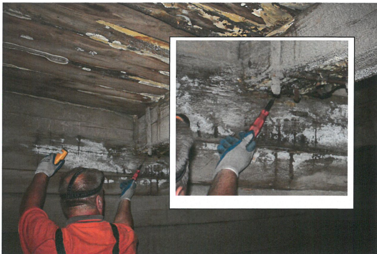
Niektóre elementy konstrukcji mocno zdegradowane, miękkie.
